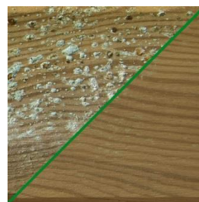
En frottant légèrement avec du papier de verre, même les taches les plus importantes laissées par le traitement peuvent s'en aller.
